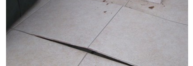
ניתוק אריחים עקב חוסר במריחה כפולה של דבק (גם בגב האריח וגם במשתית)
