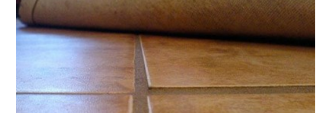
ניתוק אריחים עקב חוסר במריחה כפולה של דבק (גם בגב האריח וגם במשתית)
